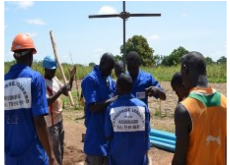
Les stagiaires de Moïse Bado en pleine activité de fonçage d'un puits traditionnel
